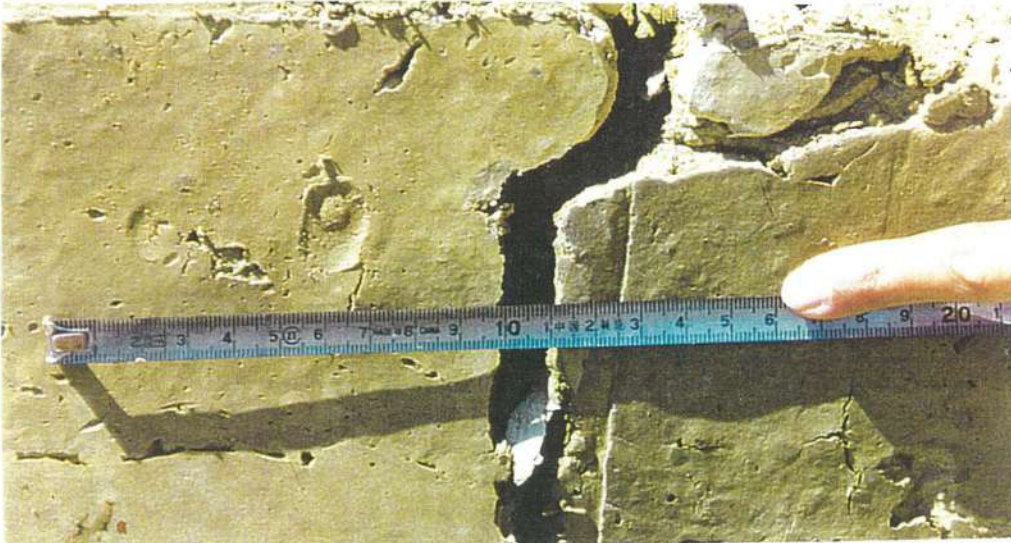
Resim 3.6 Likit Kıvamdaki Karışımın Rötre Çatlağı
