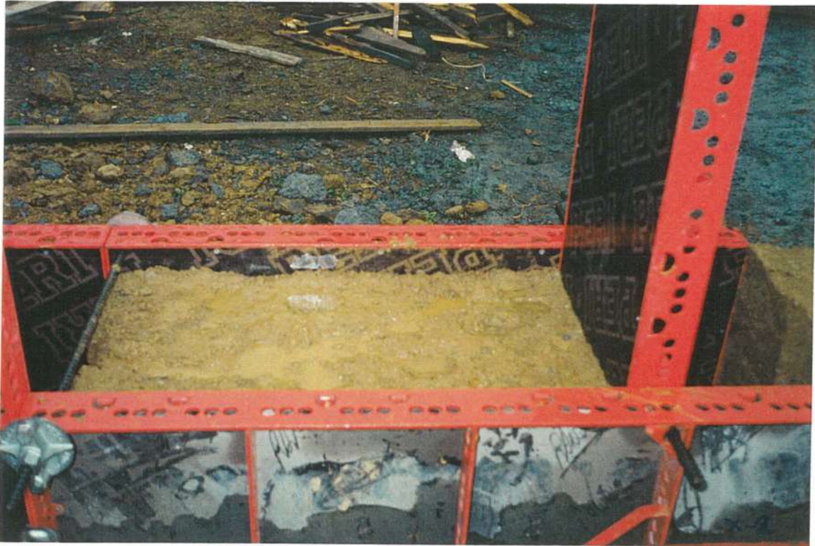
Resim 3.22 Kesintili Dökülen Duvar Örneği
