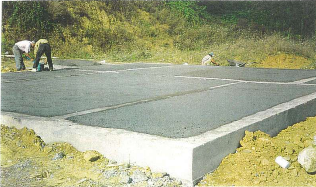
Resim 3.30 Döşeme Betonunun Dökülmesi
