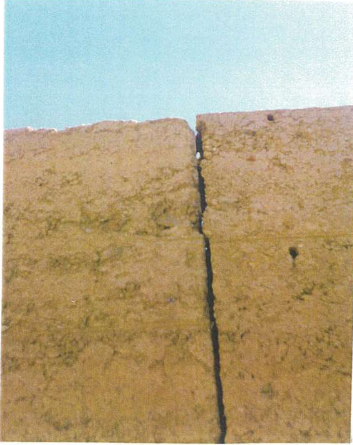
Resim 3.23 Farklı Zamanlarda Dökülen Duvarlardaki İş Derzi Problemi
