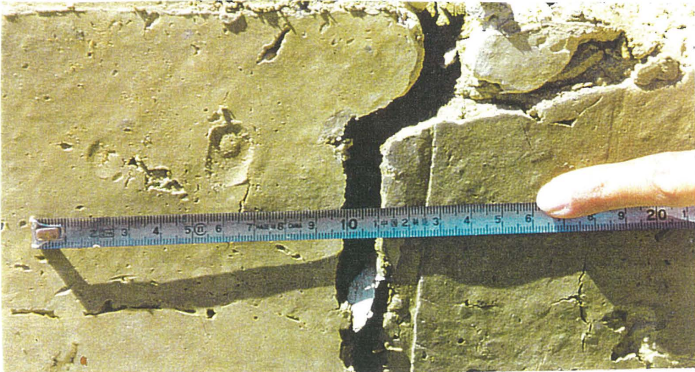
Resim 3.6 Likit Kıvamdaki Karışımın Rötre Çatlağı
