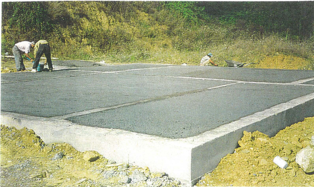
Resim 3.30 Döşeme Betonunun Dökülmesi
