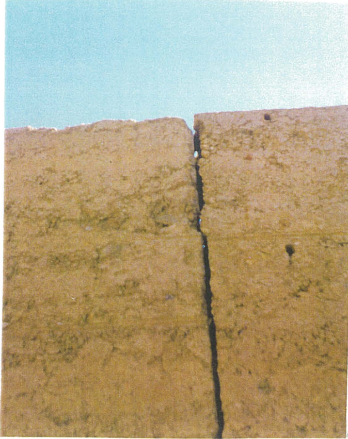
Resim 3.23 Farklı Zamanlarda Dökülen Duvarlardaki İş Derzi Problemi
