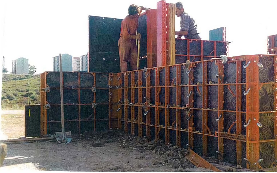
Resim 3.7. Kerpiç Duvar Dökümü İçin Kullanılan PERi Hand-set Sistem Kalıpları Picture 3.7. PERI Handset System Moulds Used for Adobe Wall Casting
